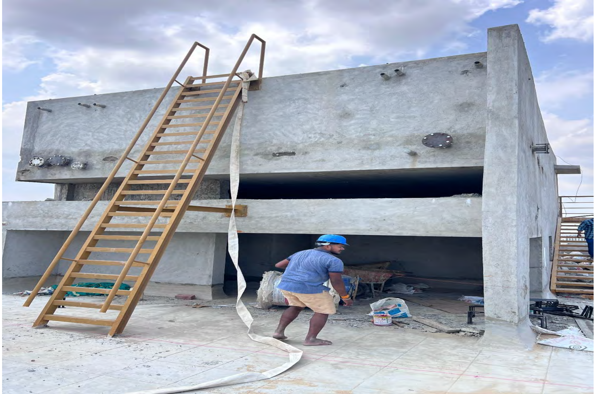
E1 B Terrace OHT MS ladder.
