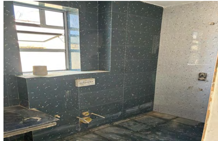
3B -MBR Toilet
